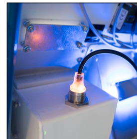
Abb. 31: Ladestecker aus Halterung entfernt
