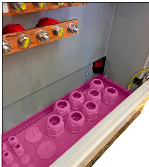
Abb. 25: Ladesäule unterer Bereich
