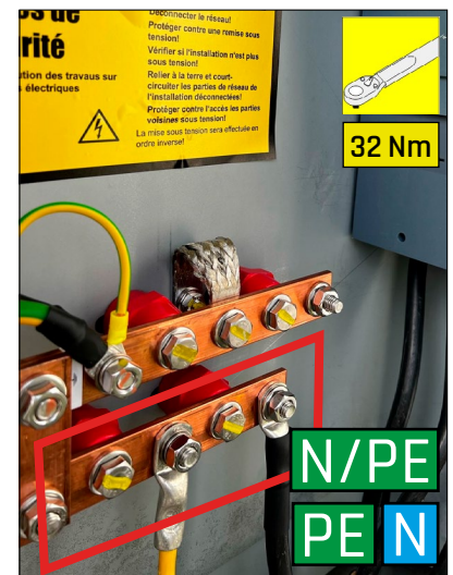
Abb. 35: Anschluss AC-Hauptzuleitung N/PE
