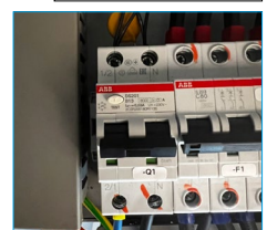
Abb. 05: Leitungs-/Fehlerstromschutzschalter und Lasttrennschalter
